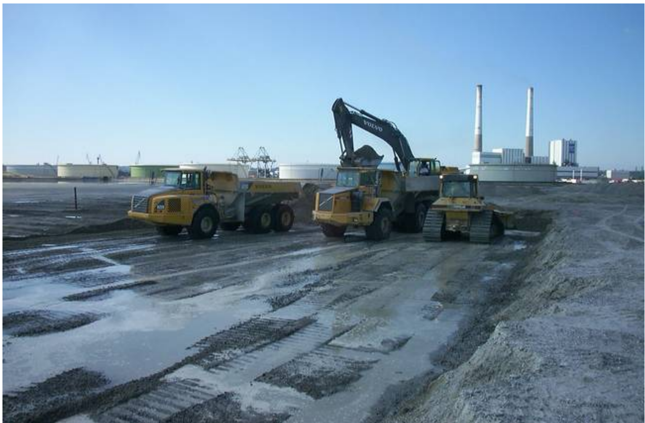
Extraction de matériaux graveleux dans casier de dragage, pour mise en remblai en arrière du quai
