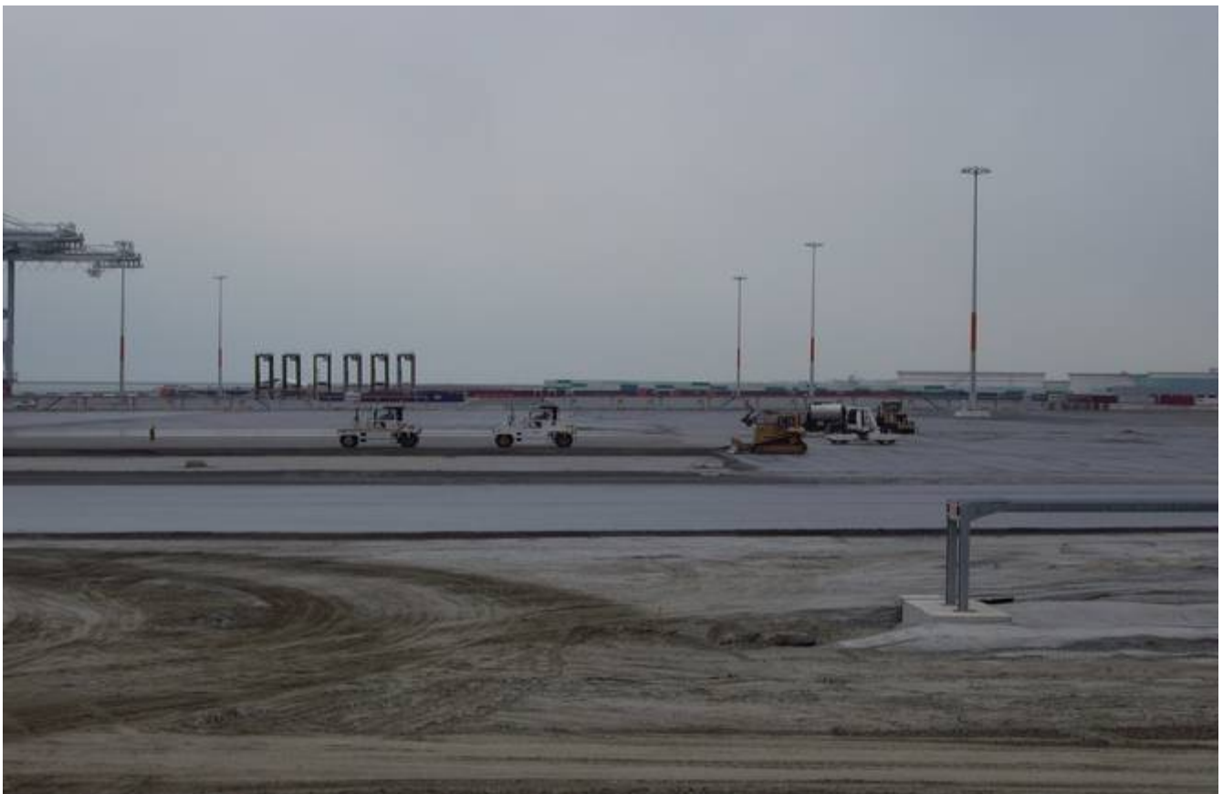
Plate-forme livrée avec pente de 2% : mise en œuvre de grave traitée sur remblai en sable
