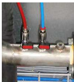
Robinettes et piquages sur l'alimentation en eau du tunnel
